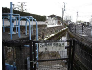
□長町内の分流設備
