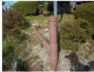
□ ポンプアップ設備
