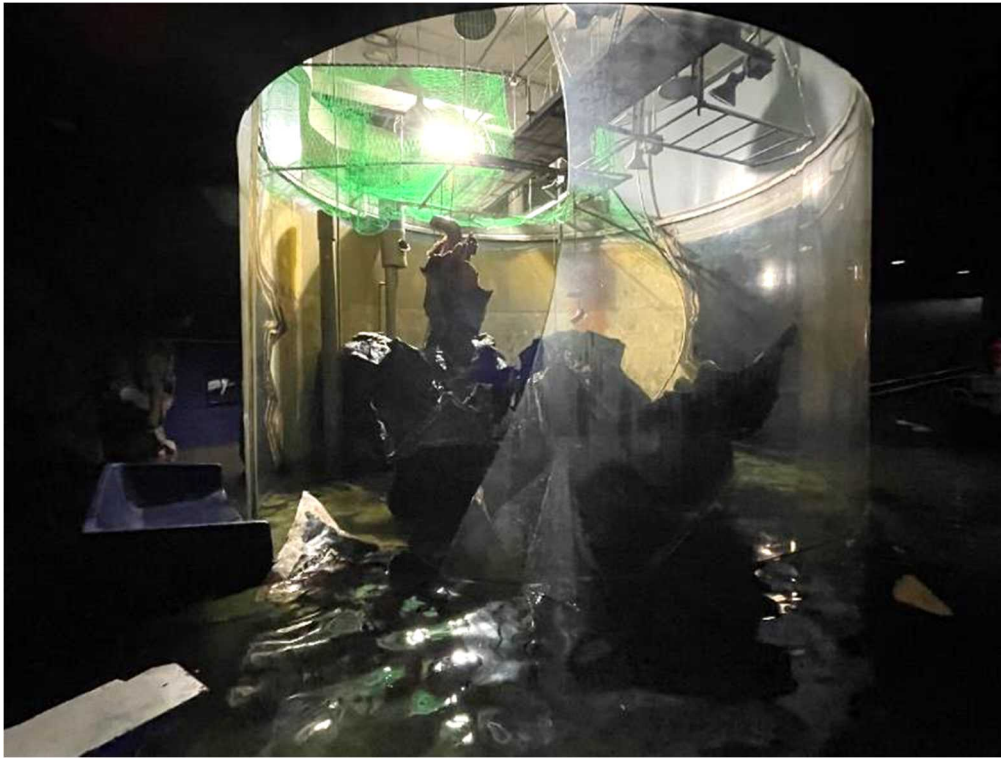
破損したビワコオオナマズ水槽
