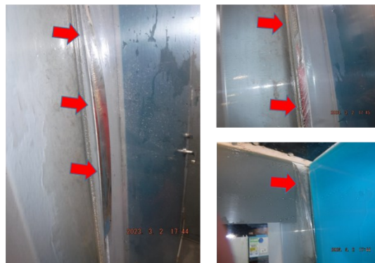
B 内部から見た水槽左側の亀裂(実線枠の部分)
