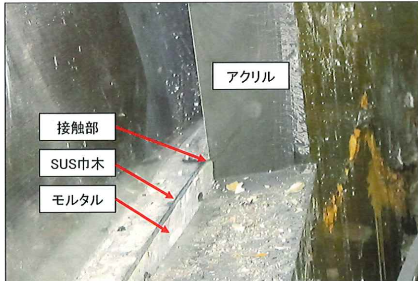
図 16 破断面 (A) 躯体部分の拡大写真
