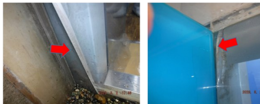
C 内部から見た水槽右側の亀裂(点線枠の部分)
