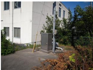
一号汲み上げ揚水機
