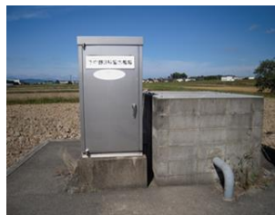
三号汲み上げ揚水機
