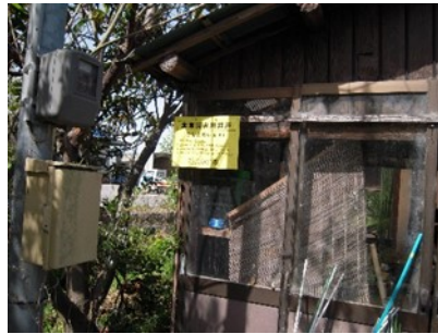
■同ポンプ設備
