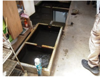
■非常災害用井戸例③
