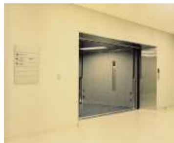
資料用の4トン積エレベーター
